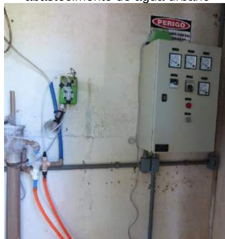
Figura IV.37 – Sistema de tratamento simplificado dos poços para o abastecimento de água urbano
