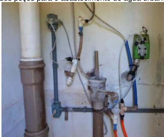
Figura IV.36 – Sistema de tratamento simplificado dos poços para o abastecimento de água urbano
