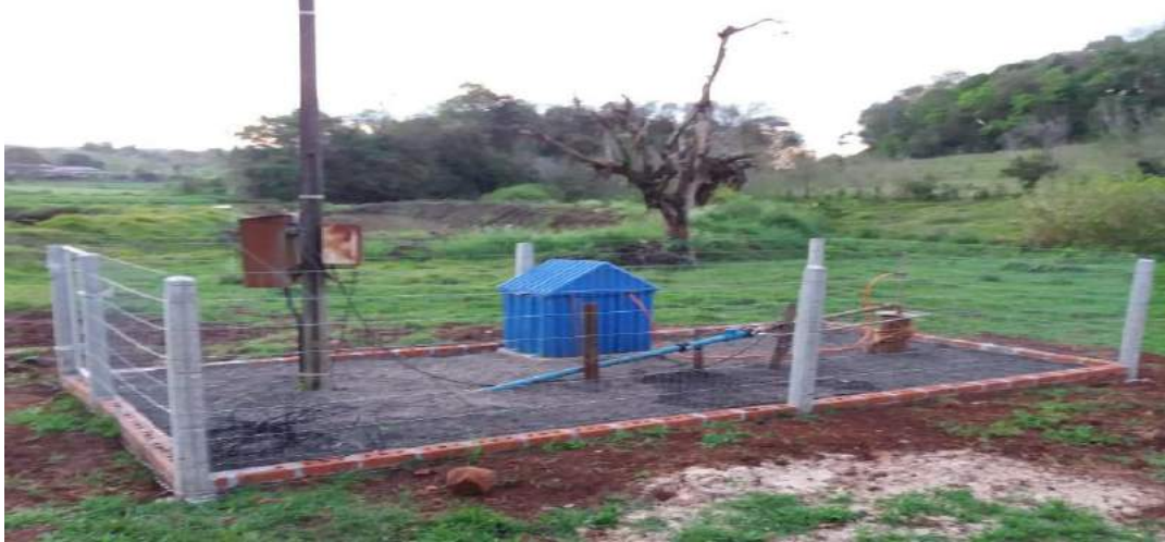
Figura IV.104 – Poço readequado da Linha São Miguel
