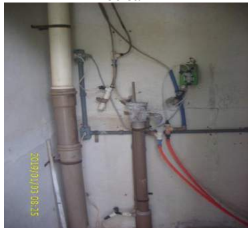
Figura IV.40 – Sistema utilizado pela Corsan
