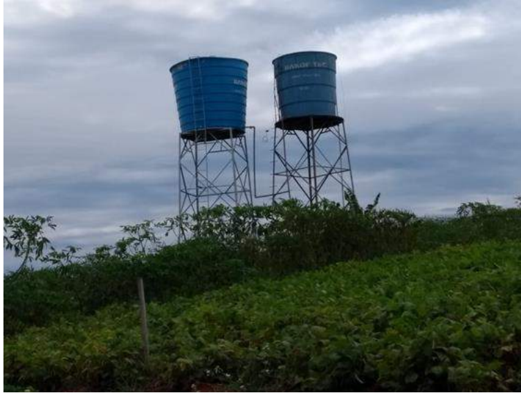
Figura IV.128 – Reservatório da Linha Esquina União
