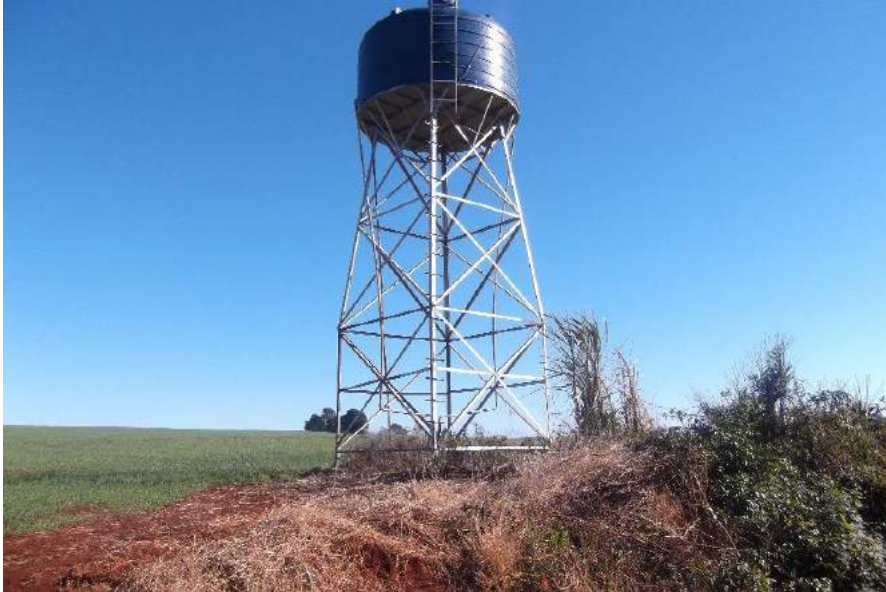
Figura IV.140 – Reservatório da Linha Dr. Pedro Toledo
