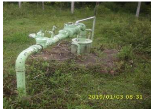
Figura IV.31 – Poço CG12 (captação de água subterrânea) na Linha Dr. Cândido Godói
