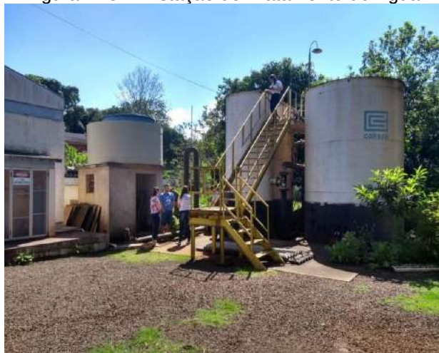
Figura IV.32 - Estação de Tratamento de Água
