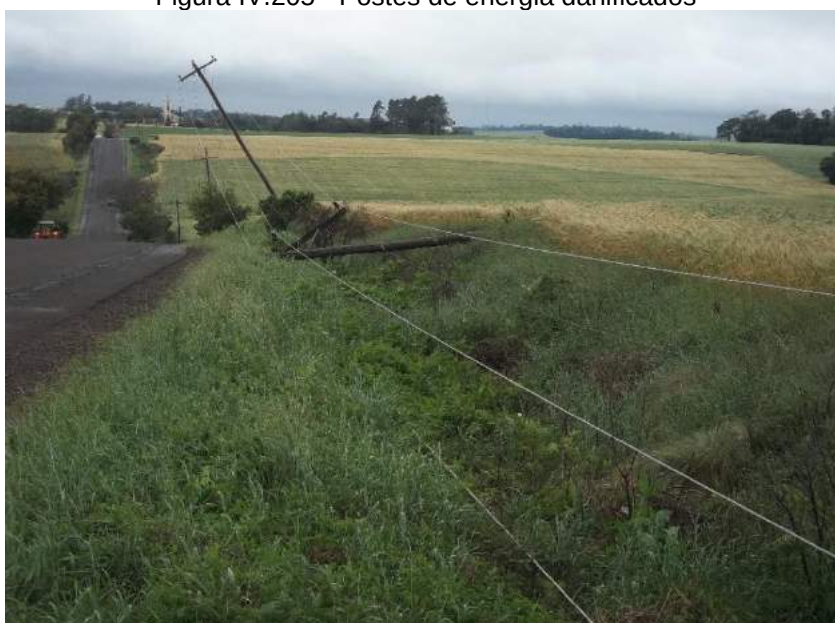
Figura IV.205 - Postes de energia danificados
