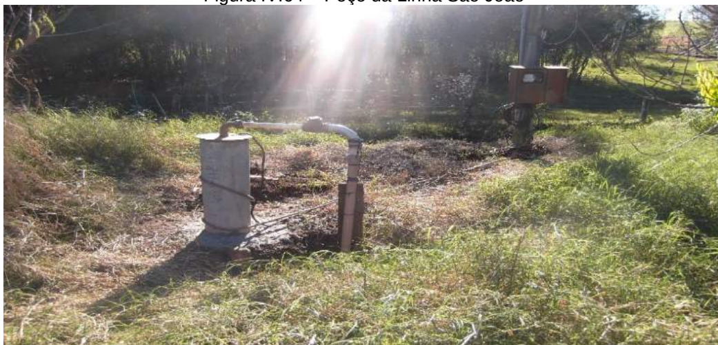
Figura IV.64 – Poço da Linha São João
