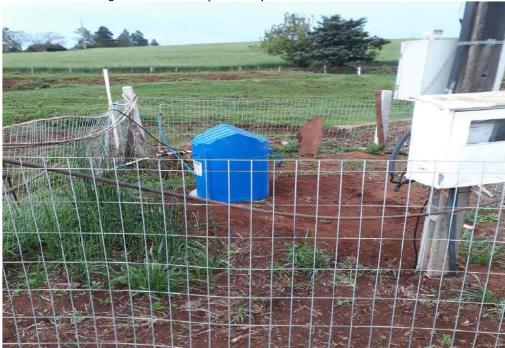
Figura IV.115 – Poço readequado da Linha Pederneira
