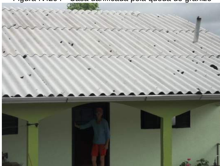
Figura IV.204 - Casa danificada pela queda de granizo
