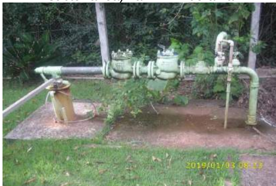
Figura IV.30 – Poço CG1 (captação de água subterrânea) na Av. Pindorama
