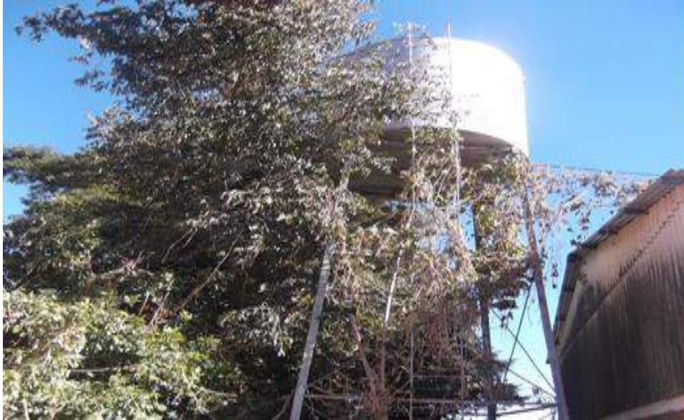
Figura IV.143 – Reservatório da Linha Dos Louros
