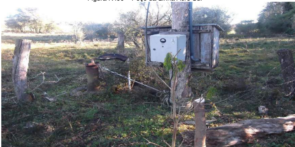
Figura IV.90 – Poço da Linha Acre Sul
