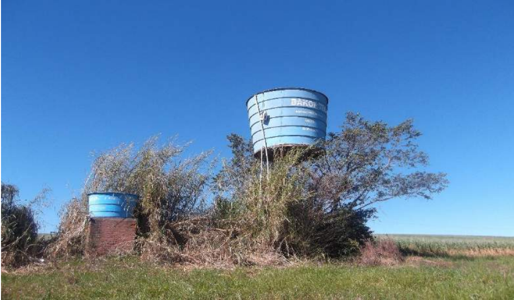
Figura IV.146 – Reservatório da Linha Timbaúva 01
