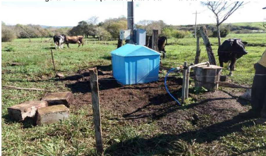
Figura IV.81 – Poço readequado da Linha São Bonifácio
