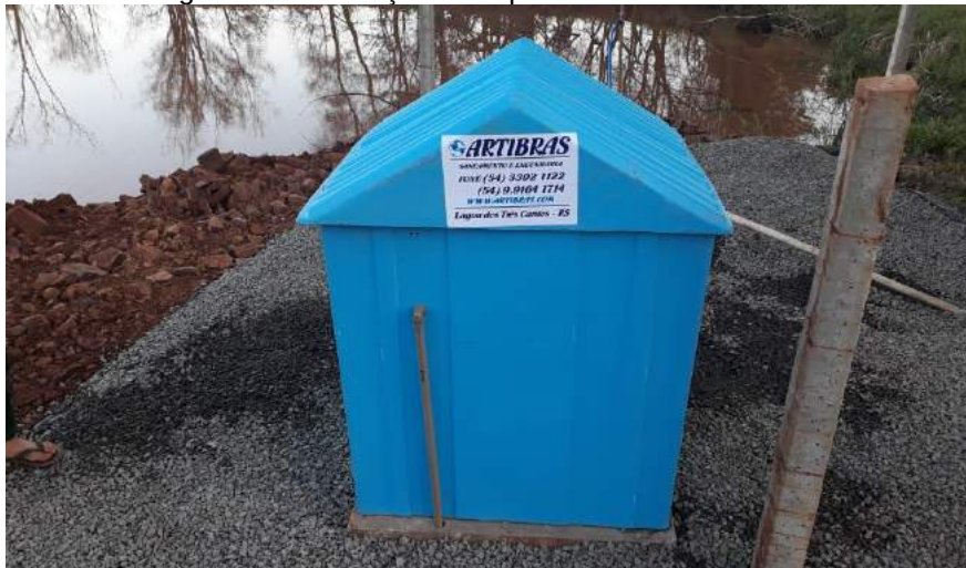
Figura IV.61 – Poço readequado da Linha Abrantes
