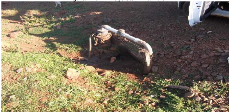
Figura IV.97 – Poço da Linha Acre
