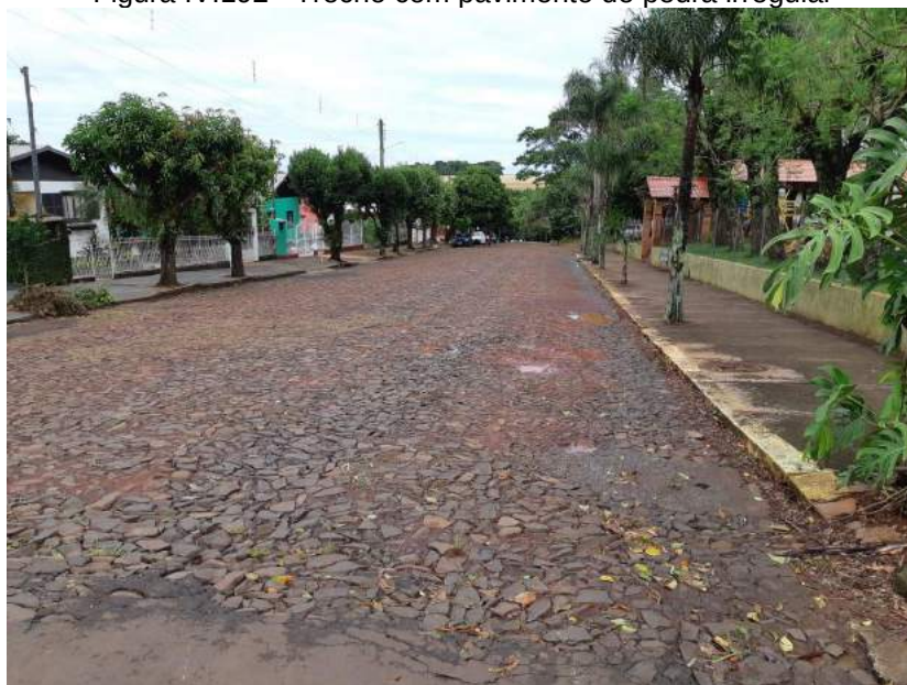
Figura IV.192 - Trecho com pavimento de pedra irregular
