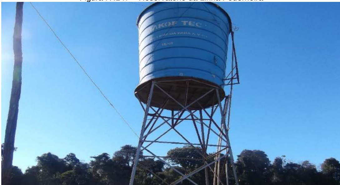
Figura IV.147 – Reservatório da Linha Pederneira
