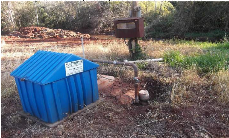
Figura IV.109 – Poço readequado da Linha Silva Jardim Sede
