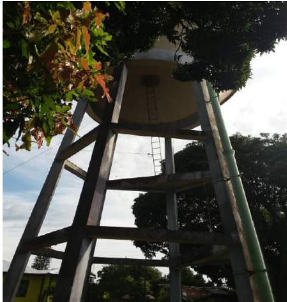
Figura IV.44 – Reservatório Corsan – Cândido Godói
