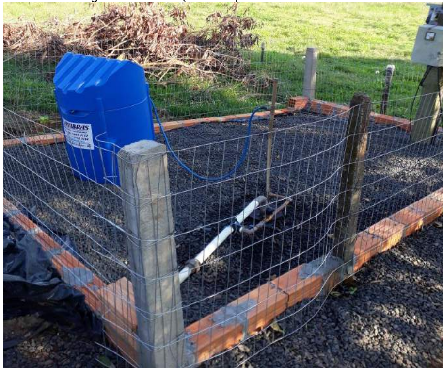
Figura IV.85 – Poço readequado da Linha La Salle
