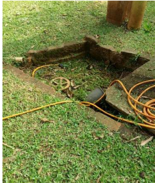
Figura IV.45 – Sistema de válvulas - Reservatório
