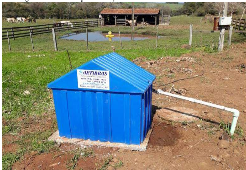
Figura IV.68 – Poço readequado da Linha Dr. Cândido Godói
