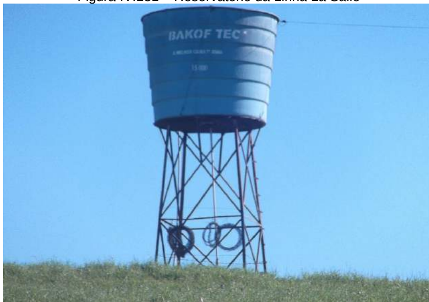
Figura IV.131 – Reservatório da Linha La Salle
