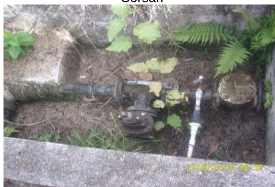
Figura IV.39 – Sistema de bombeamento da Corsan
