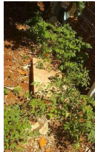
Figura IV.151 – Caixa de inspeção, destacado no quadro, para conexão à rede coletora
