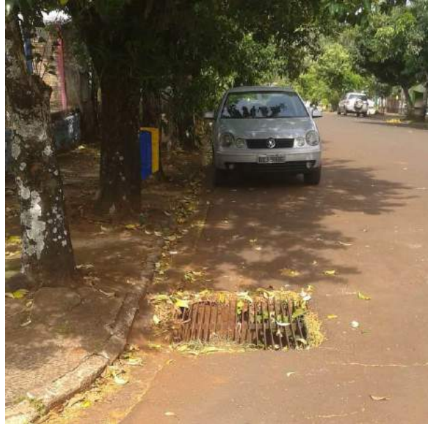
Figura IV.188 – Boca de lobo da Avenida Concórdia
