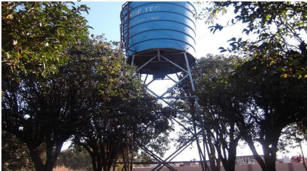
Figura IV.136 – Reservatório da Linha Paranaguá
