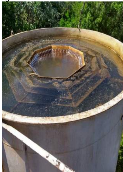
Figura IV.35 – Sistema de tratamento
