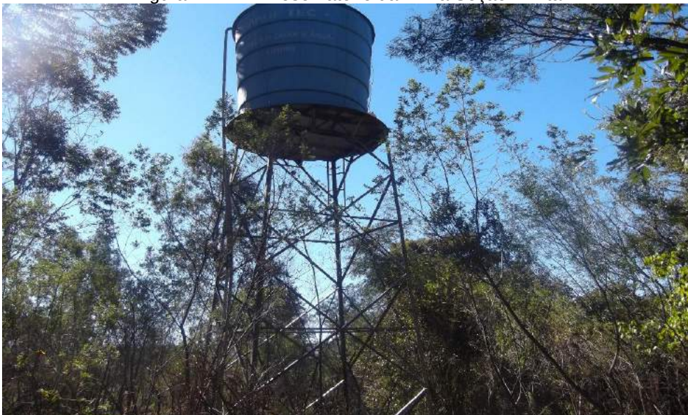
Figura IV.127 – Reservatório da Linha Seção A Alta
