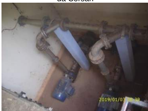
Figura IV.38 – Sistema de bombeamento da Corsan
