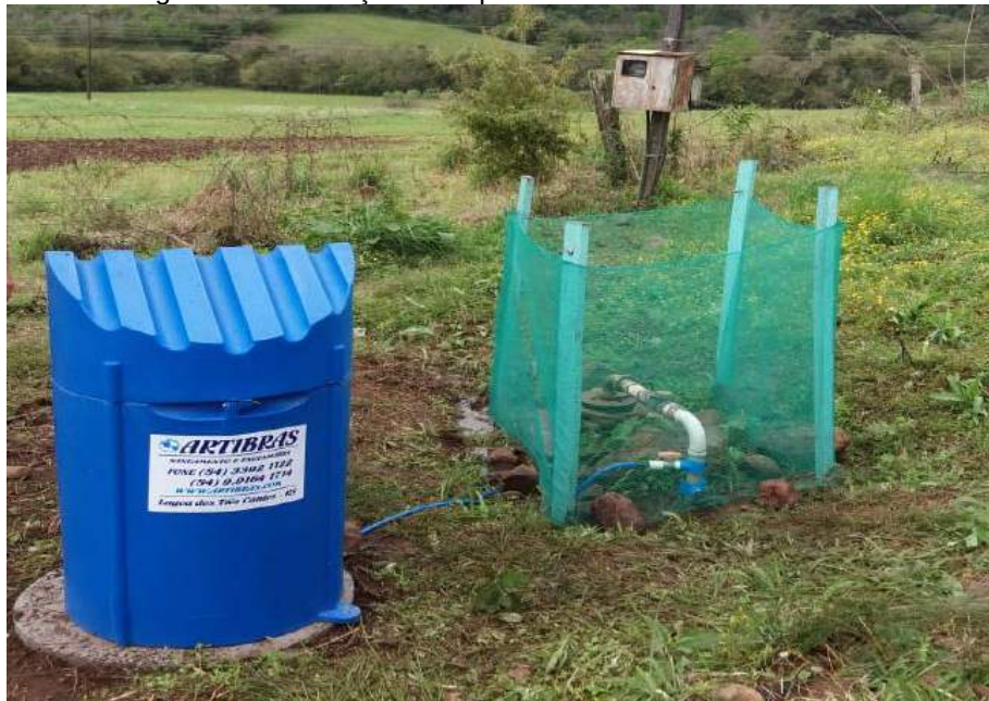
Figura IV.73 – Poço readequado da Linha Castelo Branco
