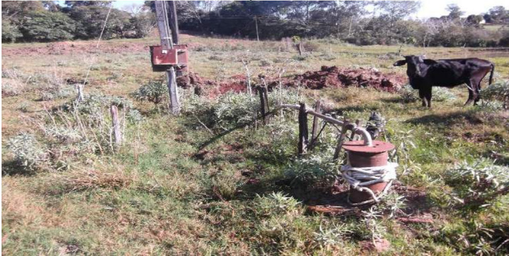
Figura IV.71 – Poço da Linha Cascata
