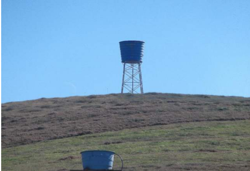
Figura IV.137 – Reservatório da Linha Timbaúva 02
